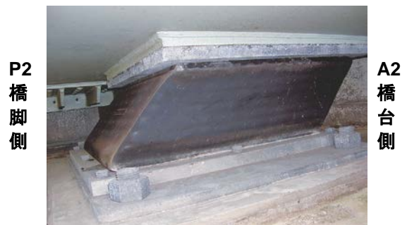
写真-2 A2橋台上のゴム支承の変形
