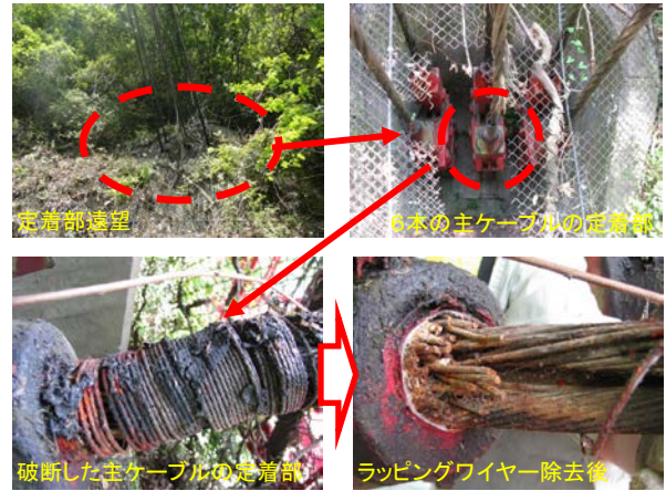
写真-1 主ケーブル破断状況
