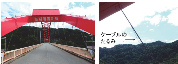
写真-1 橋梁全景とたるみが確認されたケーブル
