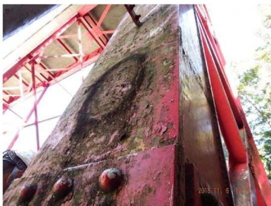
端支柱ハンドホール後埋め部
