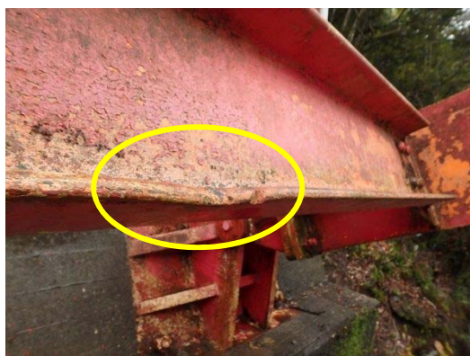
漂流物衝突痕(横支材フランジ変形)
