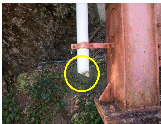
漂流物衝突痕(排水管欠損)
