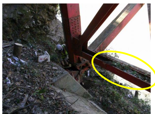
部材への土砂堆積
