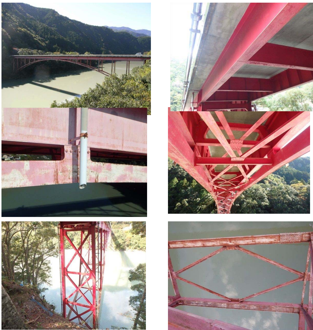
【全体的な防食機能の劣化】
