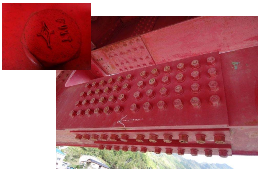
写真 F11Tボルト軸突出状況
