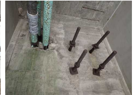
P3 落橋防止装置
