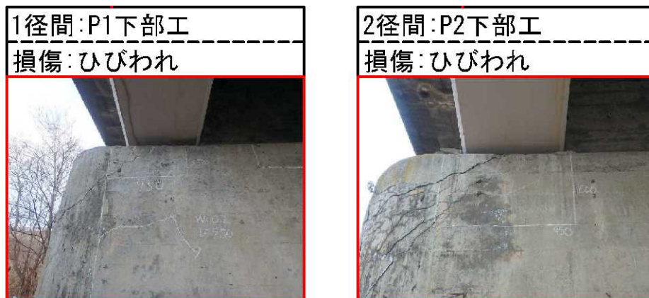
写真 5.9 下部工の損傷状況写真
