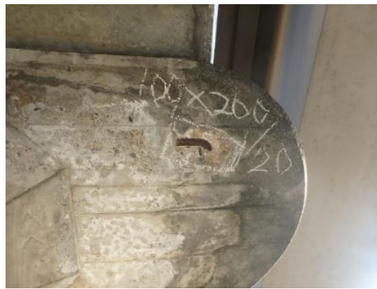
写真 4.2.3 新規に確認された鉄筋露出（P 6）
