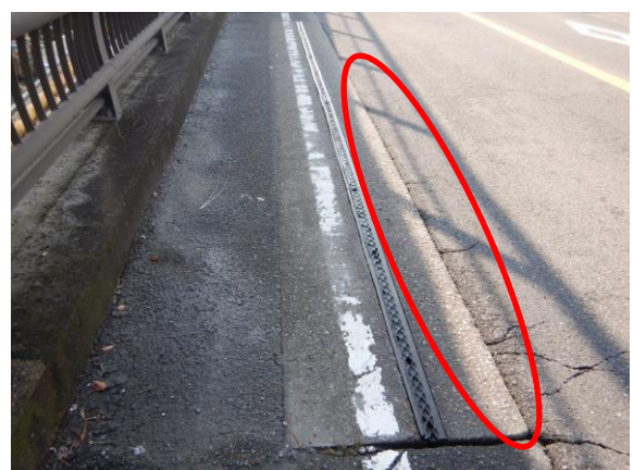
写真 4.1.11 縦目地の損傷(第5径間)
