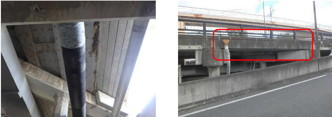
写真 4.1.9 旧歩道部桁下および地覆側面の状況(第10径間)
