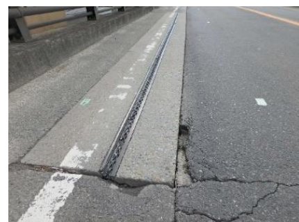
写真 2.1.7 縦目地 (第4径間)
