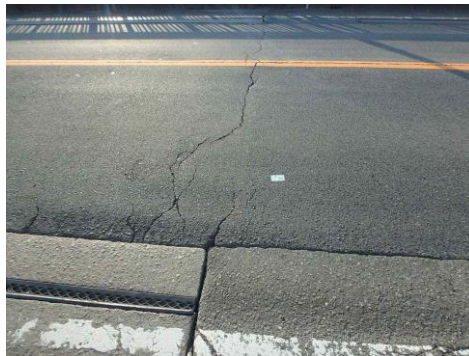
写真 4.1.1 舗装のひびわれ (P 4 上)
