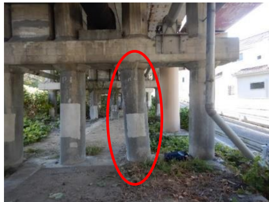
写真 4.2.4 パイルベント橋脚（下段支柱）の傾き（P 4）
