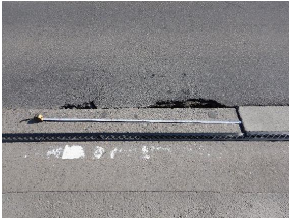
写真 4.1.12 舗装との隙間 (第 1 1 径間)
