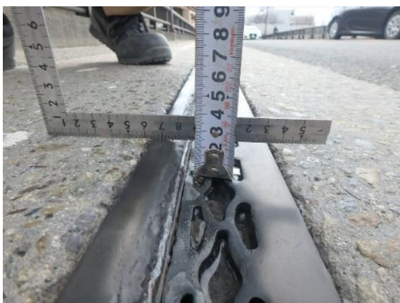
写真 4.1.10 止水材の破断や橋軸直角方向の段差(第4径間)
