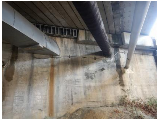
写真 4.2.1 A2 橋台の漏水
