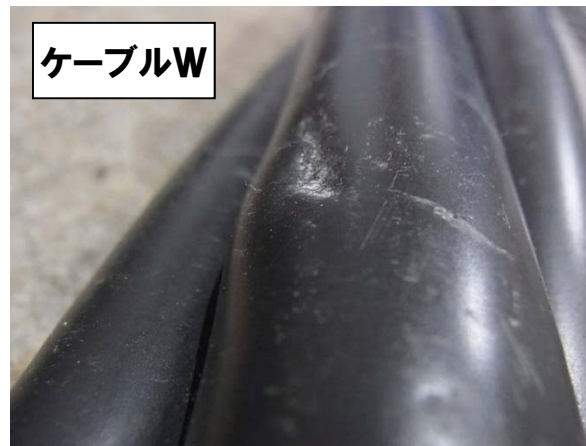
つぶされ変形した傷
