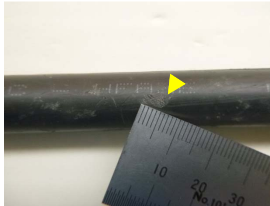
【損傷】傷の大きさ（長さ）5mm
