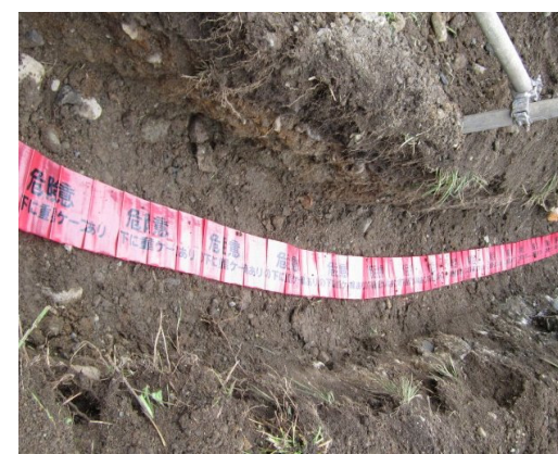
通信線の設置例
