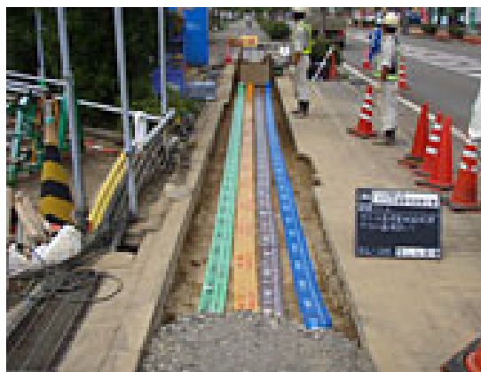
左からガス、電力、下水道、水道
