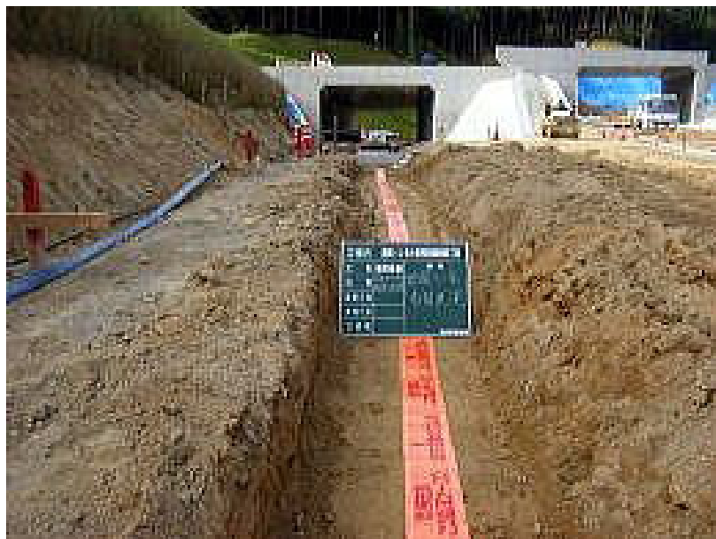
国土交通省東北地方整備局南三陸国道事務所大船渡監督官室 http://www.thr.mlit.go.jp/Bumon/J73501/homepage/10_iji/ofunato/daikan/tk_shomei1.html
