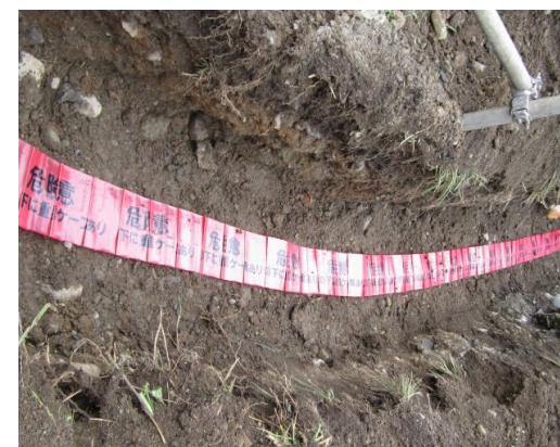
通信線の設置例
